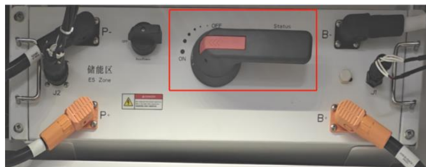
Abbildung 58 – Batterietrennschalter QB im Hochspannungsschrank
