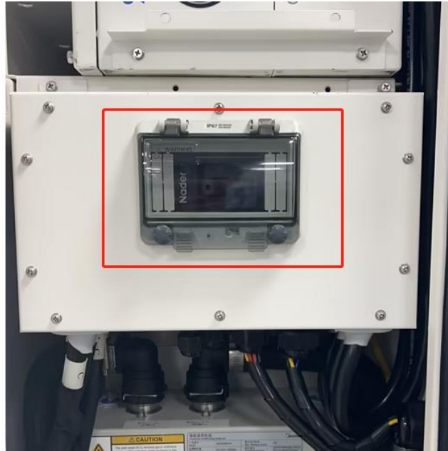
Abbildung 59 – AC-seitiger Schalter QA0 des Energiespeicherschrankes
