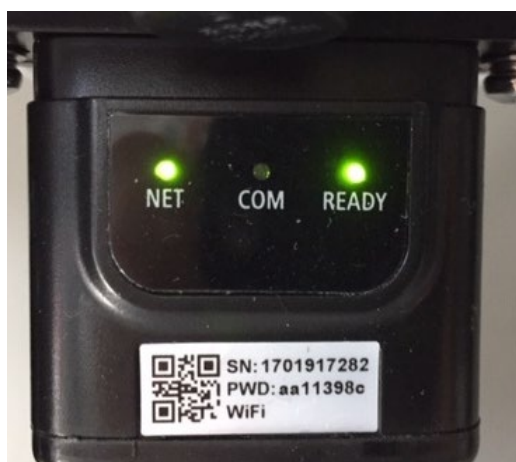
Figura 73 - Stato di comunicazione irregolare tra l'inverter e l'adattatore
