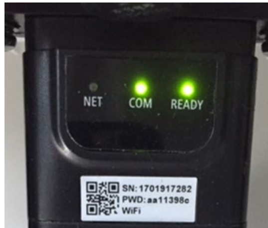
Figura 74 - Stato di comunicazione irregolare tra l'adattatore e il server remoto
