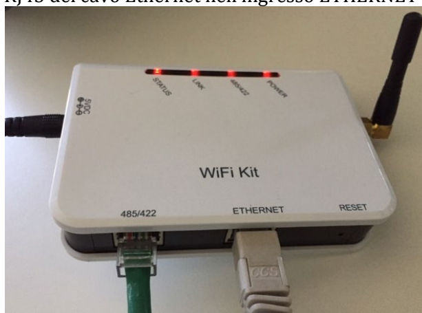
Figura 89 – Cavo Ethernet collegato al datalogger
