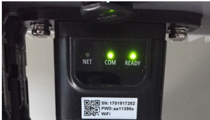
Figura 71 - Stato iniziale dei LED
