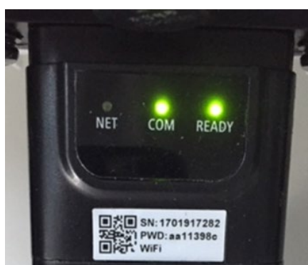
Figura 80 - Stato di comunicazione irregolare tra l'adattatore e il server remoto
