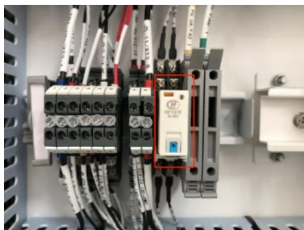
Figura 32 – pulsante di prova della ventola di scarico
