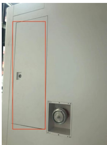
Figura 43 - Porta di accesso alla bombola antincendio
