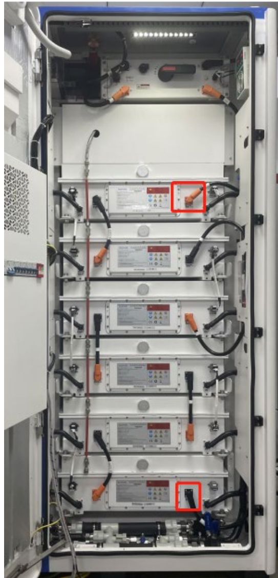
Figura 2 - Posizione delle spine positiva e negativa del cluster della batteria
