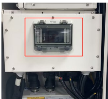
Figura 26 - interruttore di circuito CA
