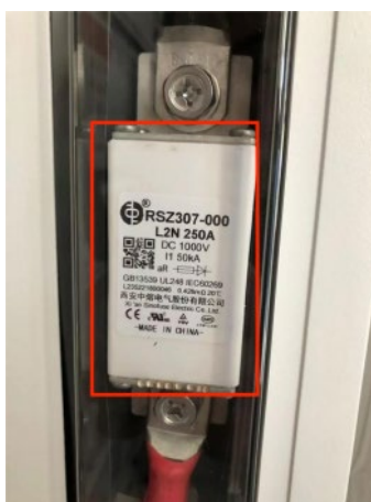
Figura 18 - fusibile del cluster della batteria
