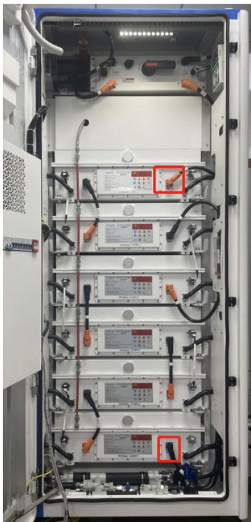
Figura 56 – Posizioni delle spine positiva e negativa del cluster della batteria
