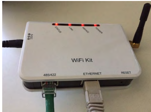
Figura 162 – Cavo ethernet connesso al datalogger
