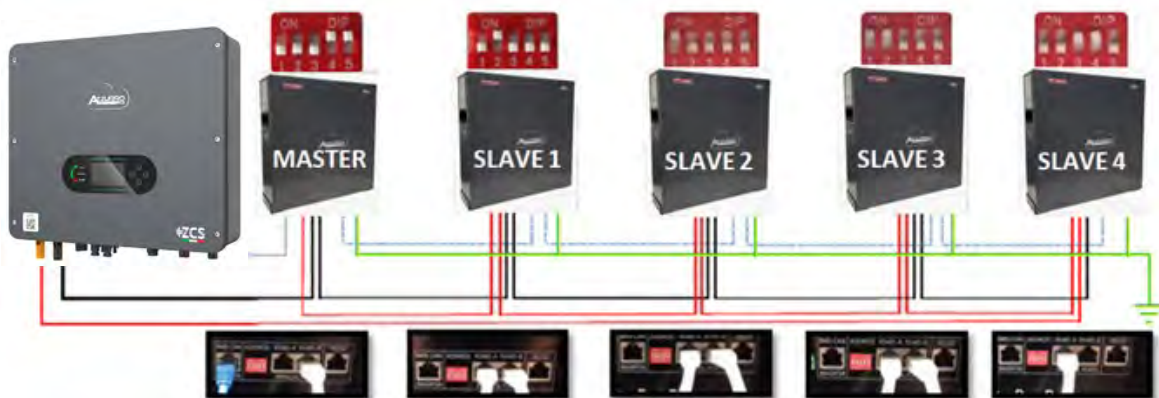
Figura 30 - Collegamento in parallelo di cinque batterie WeCo 4k4
