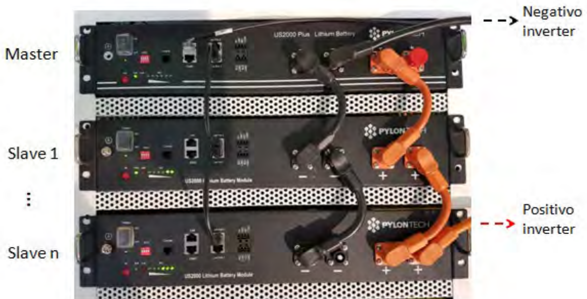
Figura 17 - Collegamento di tre batterie Pylontech in parallelo
