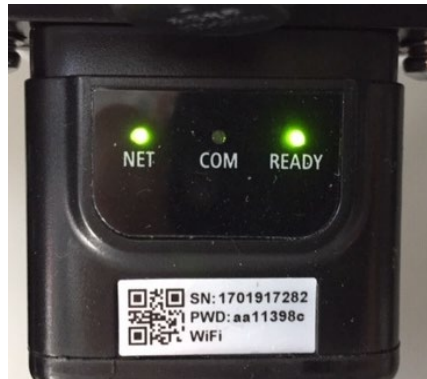
Figura 250 - Stato di comunicazione irregolare tra inverter e scheda
