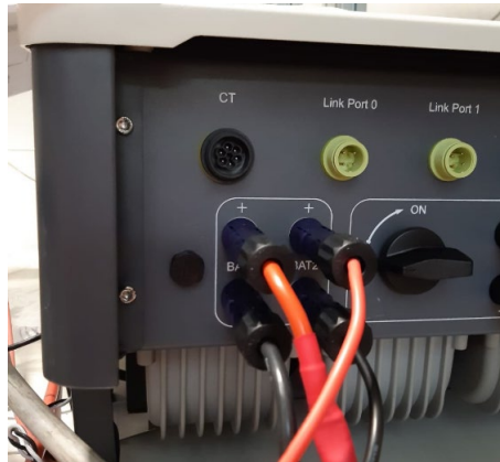
Figura 56 - Connessione potenza DC lato inverter con due ingressi batterie popolati
