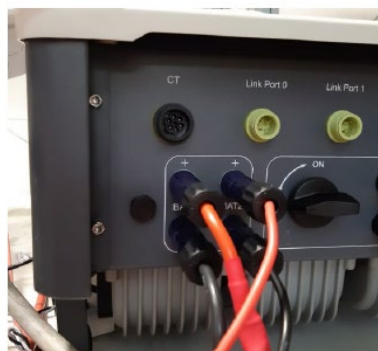
Figura 167 - Connessione potenza DC lato inverter con due ingressi batteria popolati
