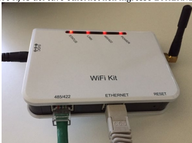
Figura 262 – Cavo ethernet connesso al datalogger
