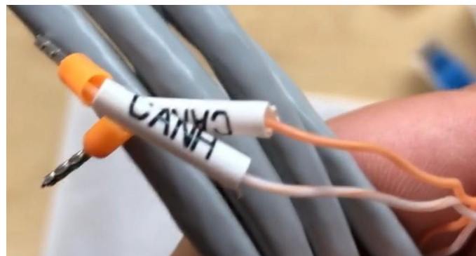
Figura 93 - Cavo comunicazione Inverter/HV BOX
