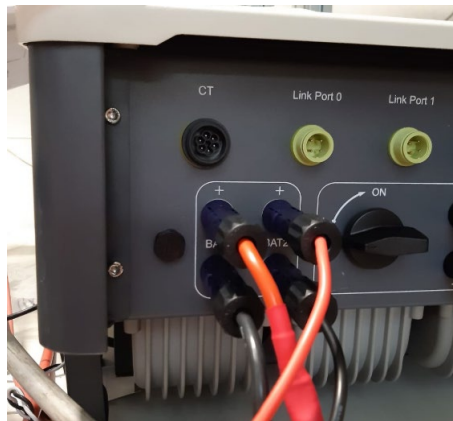
Figura 87 - Connessione potenza DC lato inverter con due ingressi batteria popolati
