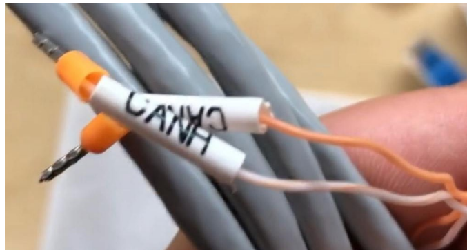
Figura 81 - Cavo comunicazione Inverter/HV BOX
