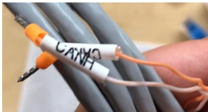
Figura 70 - Cavo comunicazione Inverter/HV BOX
