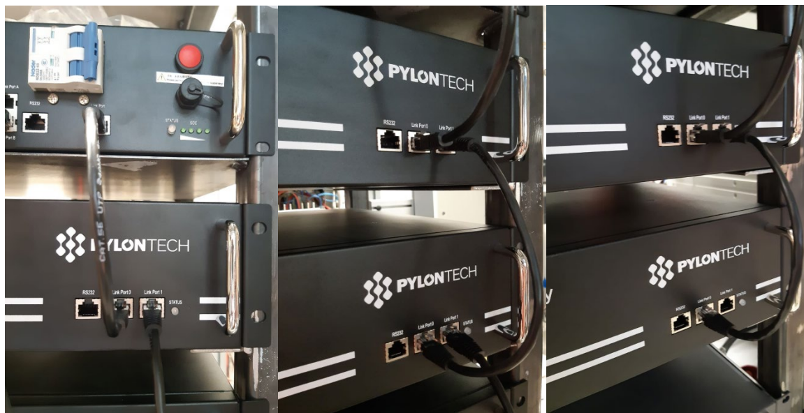
Figura 31 - Connessioni comunicazione: BMS e primo modulo batteria (sinistra), connessione fra moduli batteria (al centro), connessione fra penultimo ed ultimo modulo batteria della serie (destra)
