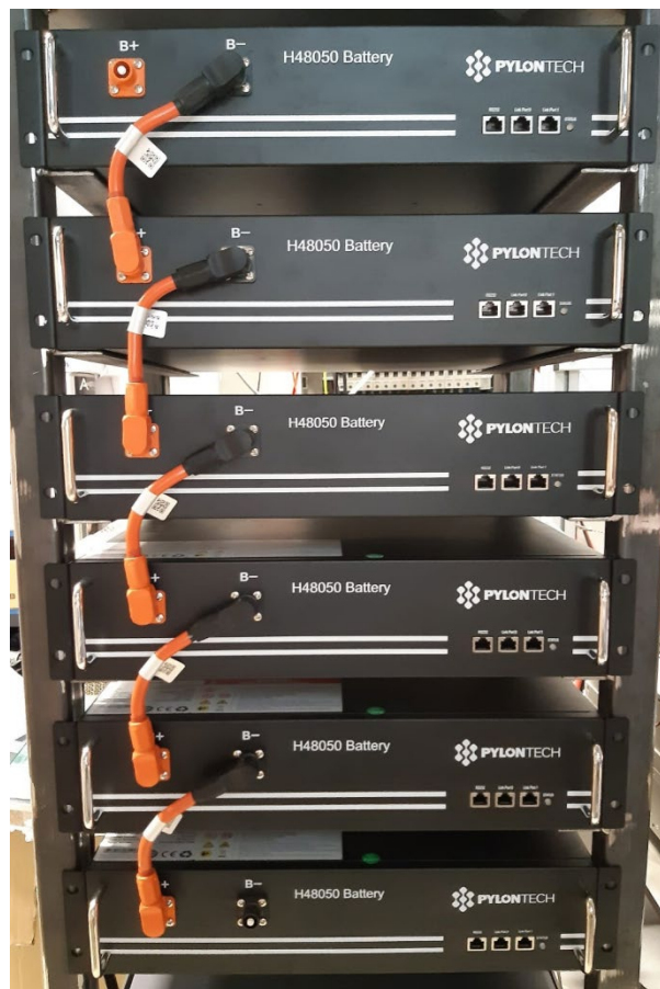
Figura 42 - Cablaggio potenza fra moduli batteria
