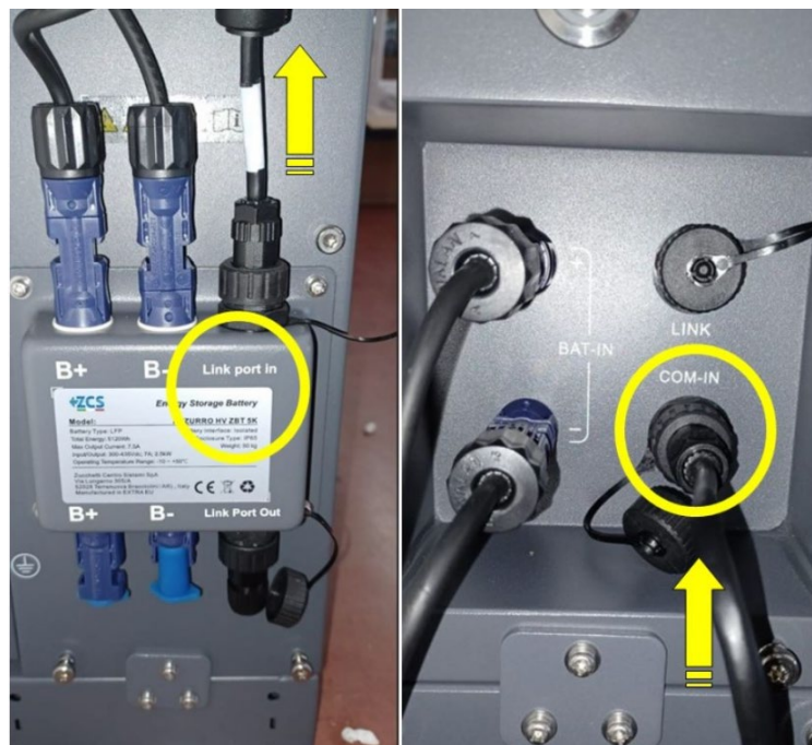
Figura 132 - Connessioni comunicazione: BDU e primo modulo batteria
