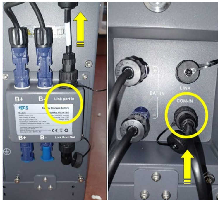
Figura 116 - Connessioni comunicazione: BDU e primo modulo batteria
