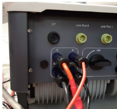
Figura 183 - Connessione potenza DC lato inverter con doppio ingresso batteria popolato
