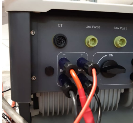
Figura 148 - Connessione potenza DC lato inverter con doppio ingresso batteria popolato
