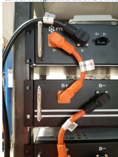
Figura 44 - Connessione di potenza (positivo) fra BMS e primo modulo batteria
