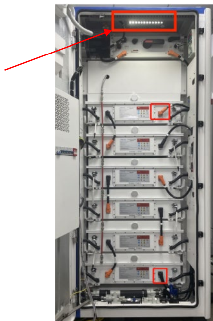
Figura 28 – tira de iluminación interna
