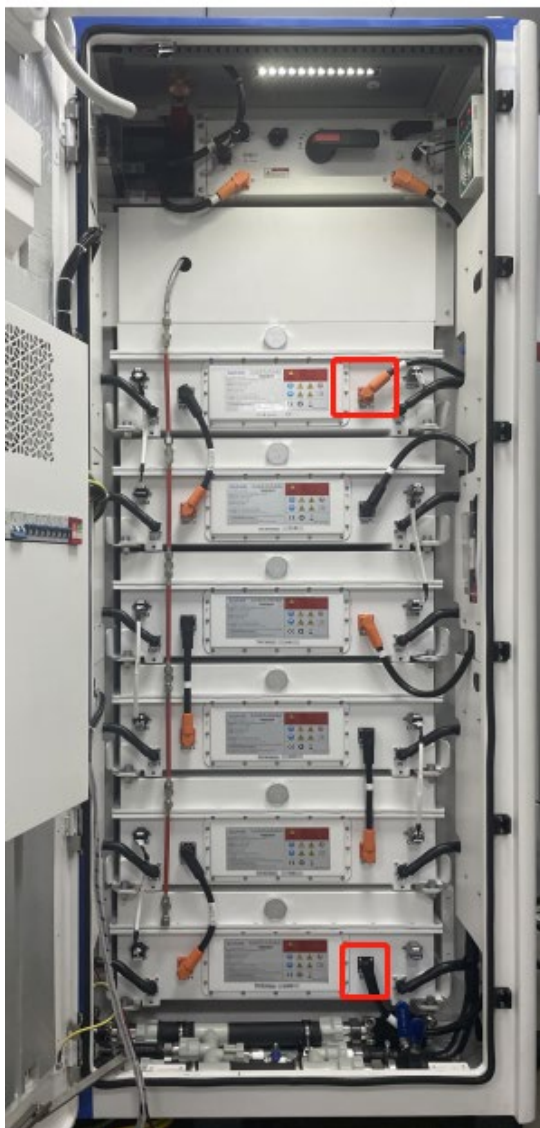
Figura 2 – Posición de las clavijas positiva y negativa del clúster de la batería
