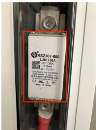
Figura 18 – fusible del clúster de la batería
