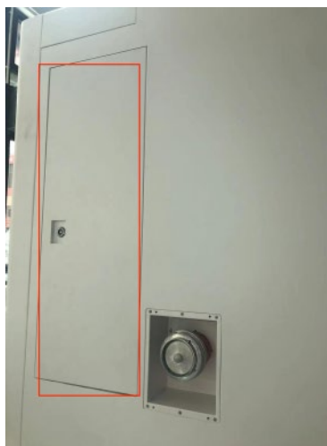
Figura 43 - Puerta de acceso a la bombona antiincendios
