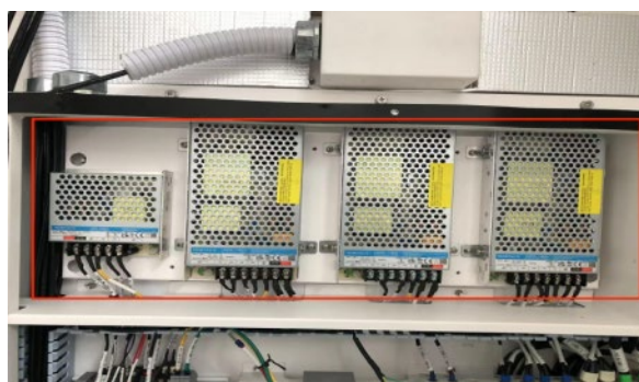
Figure 35 - Alimentation électrique de commutation
