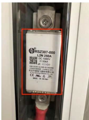
Figure 18 – Fusible du cluster de la batterie
