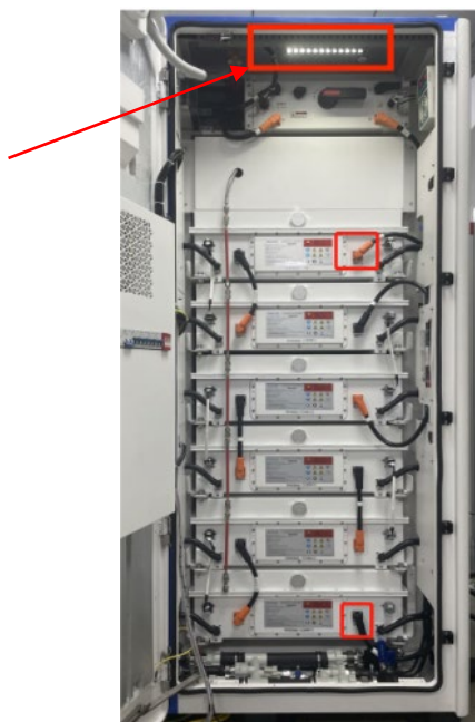
Figure 28 - Bande d'éclairage interne
