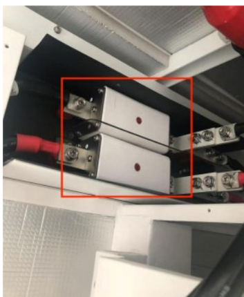
Rysunek 17 – bezpieczniki obwodu głównego
