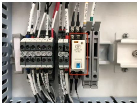
Рисунок 32 – тестова кнопка витяжного вентилятора
