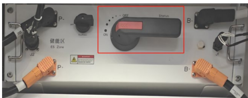
Figura 58 - Interruptor de desconexión de la batería QB en la caja de alta tensión
