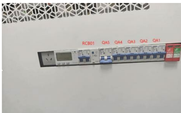
Figura 57 – Interruptores de los módulos auxiliares
