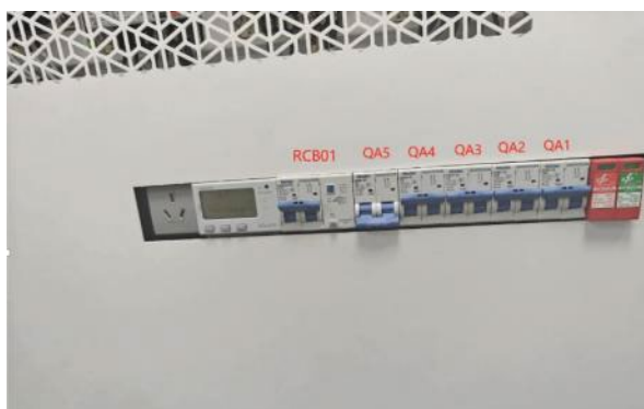
Figura 62 - Interruptores de los módulos auxiliares
