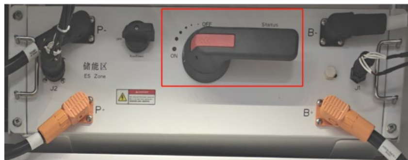
Figure 58 – Interrupteur de déconnexion de la batterie QB dans la boîte haute tension
