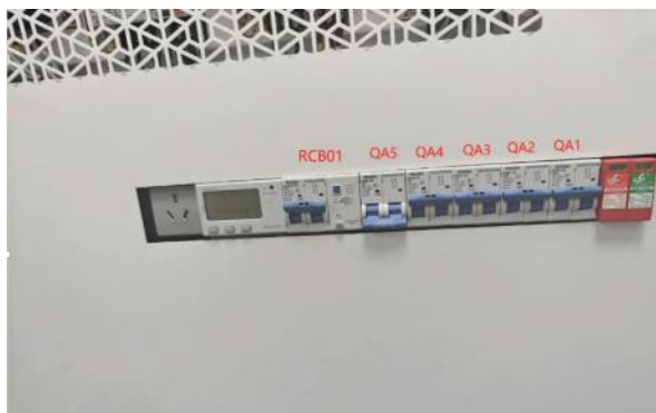
Figure 62 – Interrupteurs des modules auxiliaires
