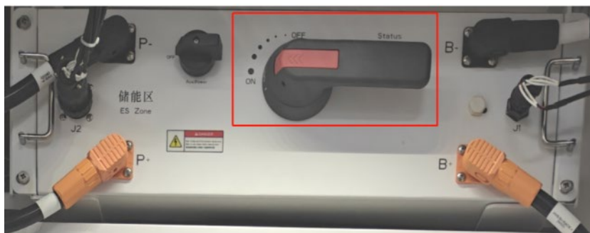
Rysunek 60 – Odłącznik baterii QB w skrzynce wysokiego napięcia
