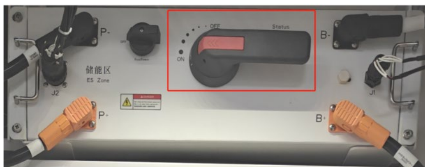
Rysunek 58 - Odłącznik baterii QB w skrzynce wysokiego napięcia
