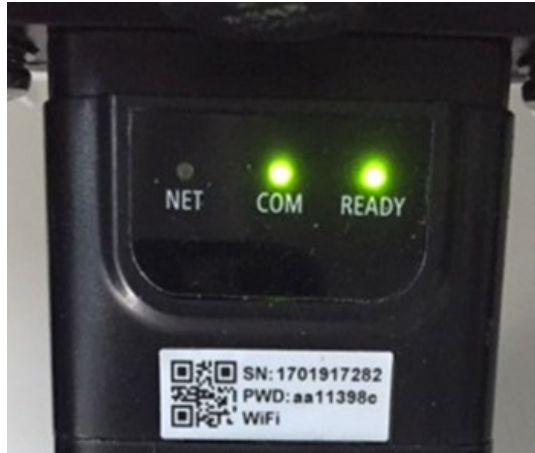
Abbildung 146 – Unregelmäßiger Kommunikationsstatus zwischen Platine und Remote-Server
