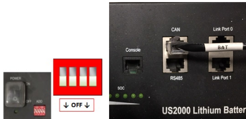
Figure 19 – Connexion du câble de communication à la batterie Pylontech
