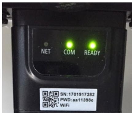
Figure 151 – État de communication irrégulière entre carte et serveur à distance
