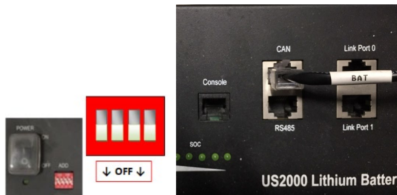
Figure 14 – Connexion du câble de communication à la batterie Pylontech
