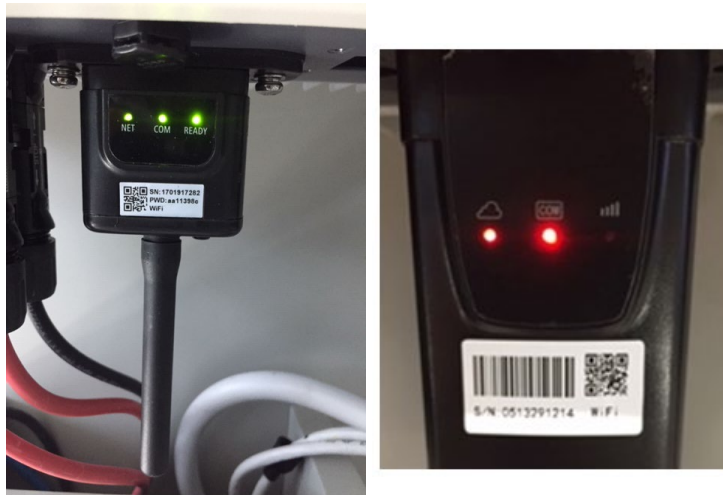
Figure 131 – État final des led
