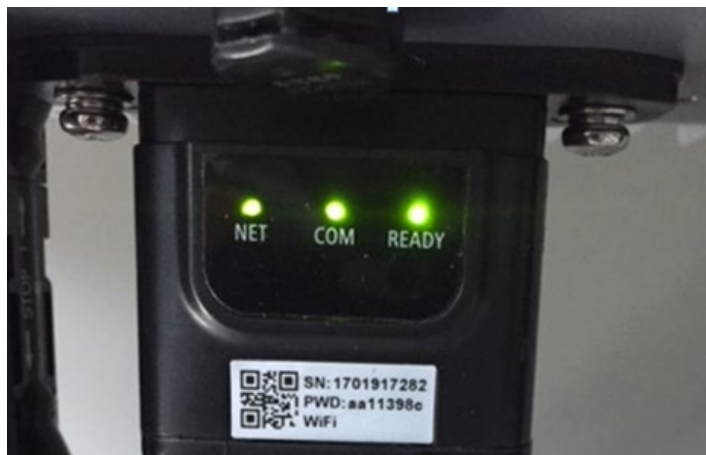
Figura 72 - Estado final de los LED
