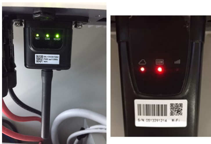
Figura 60 - Estado final de los LED
