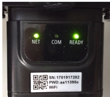
Figura 79 - Estado de comunicación irregular entre inversor y adaptador
