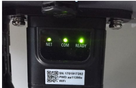
Figura 78 - Estado final de los LED
