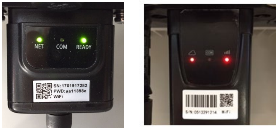
Figura 62 - Estado de comunicación irregular entre inversor y Wi-Fi
