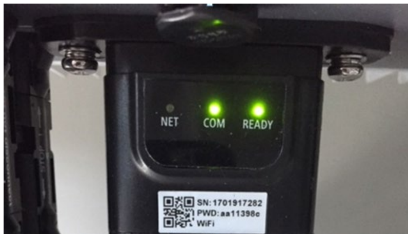
Figura 71 - Estado inicial de los LED
