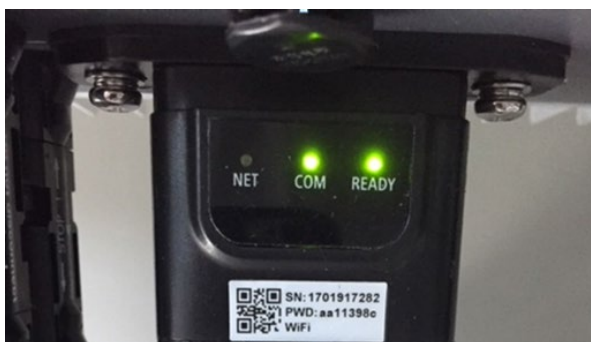
Figura 77 - Estado inicial de los LED
