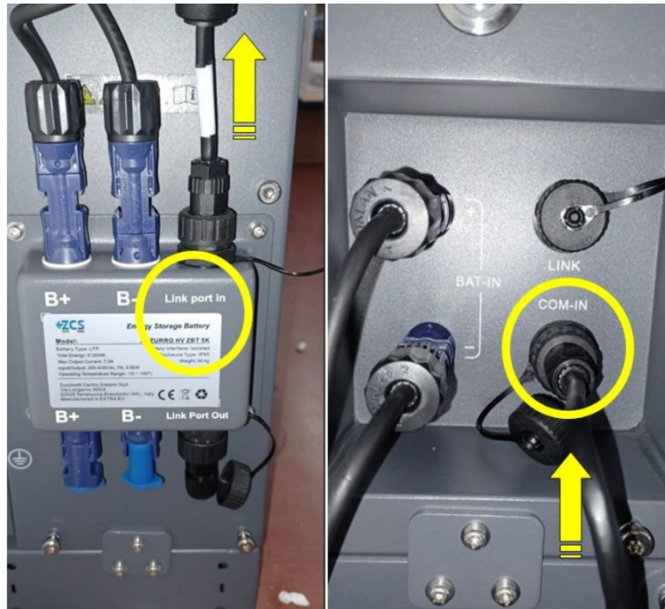
Abbildung 116 - Kommunikationsanschlüsse: BDU und erstes Batteriemodul
