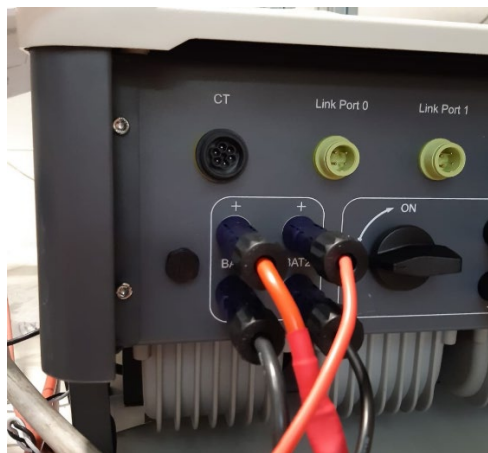
Abbildung 78 - DC-Stromanschluss Inverterseite mit einem belegten doppelten Batterieeingang
