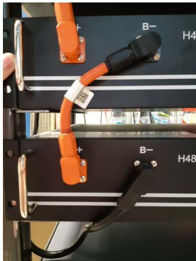
Abbildung 45 - Stromanschluss (negativ) zwischen BMS und letztem Batteriemodul
