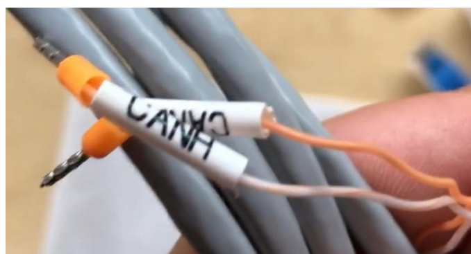
Abbildung 93 - Kommunikationskabel Inverter/HV BOX
