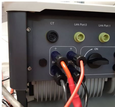
Abbildung 111 - DC-Stromanschluss Inverterseite mit zwei belegten Batterie-Eingängen
