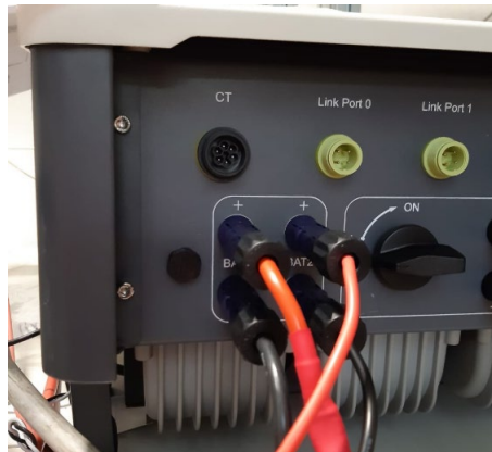
Abbildung 148 - DC-Stromanschluss Inverterseite mit belegtem doppeltem Batterie-Eingang
