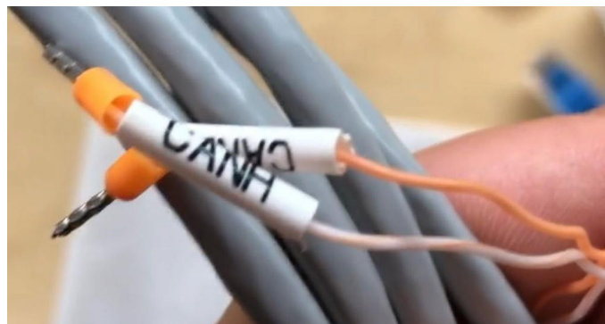
Abbildung 70 - Kommunikationskabel Inverter/HV BOX
