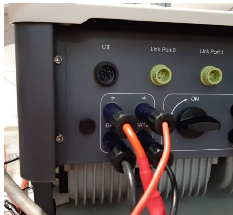
Abbildung 87 - DC-Stromanschluss Inverterseite mit zwei belegten Batterie-Eingängen
