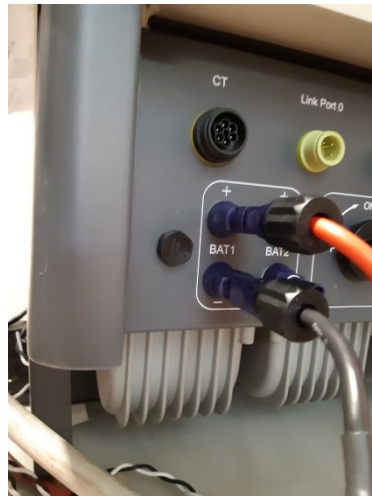
Abbildung 48 - DC-Stromanschluss Inverterseite mit nur einem belegten Batterieeingang
