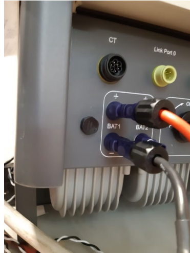
Abbildung 130 - DC-Stromanschluss Inverterseite mit nur einem belegten Batterieeingang
