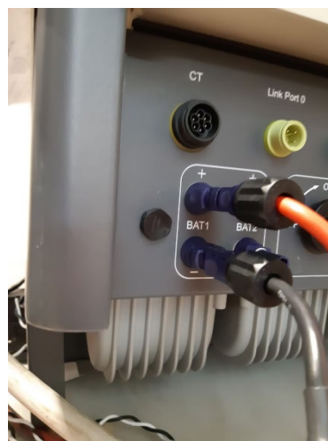
Abbildung 164 - Wechselrichter-seitig DC-Stromanschluss mit nur einem Batterieeingang
