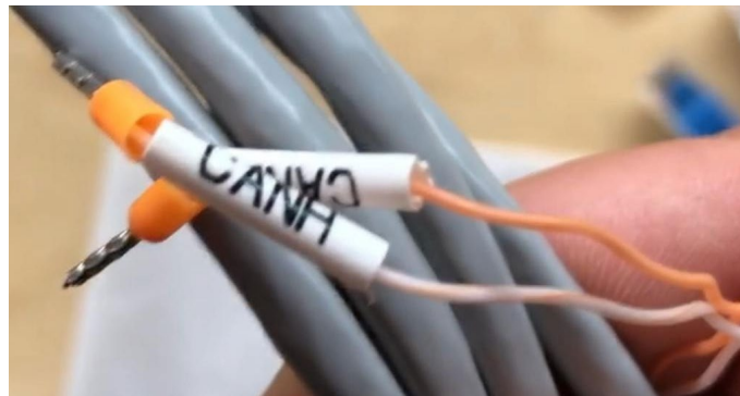
Abbildung 81 - Kommunikationskabel Inverter/HV BOX
