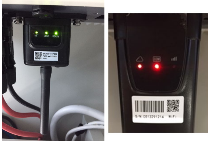
Figura 231 - Estado final de los led
