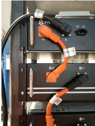
Figura 44 - Conexión de potencia (positivo) entre BMS y primer módulo de batería
