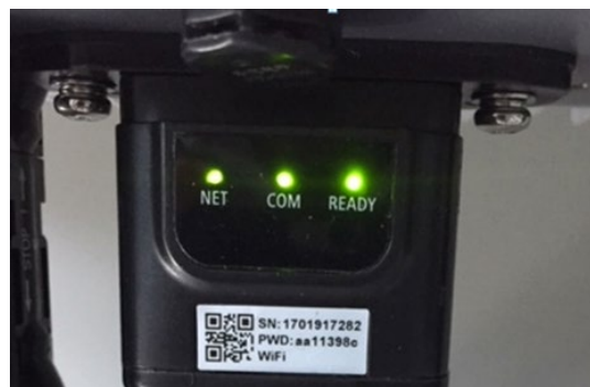
Figura 249 - Estado final de los led
