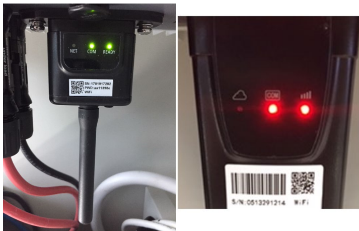
Figura 230 – Estado inicial de los led
