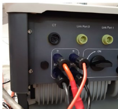
Figura 167 - Conexión de potencia DC del lado del inversor con dos entradas de batería cargadas
