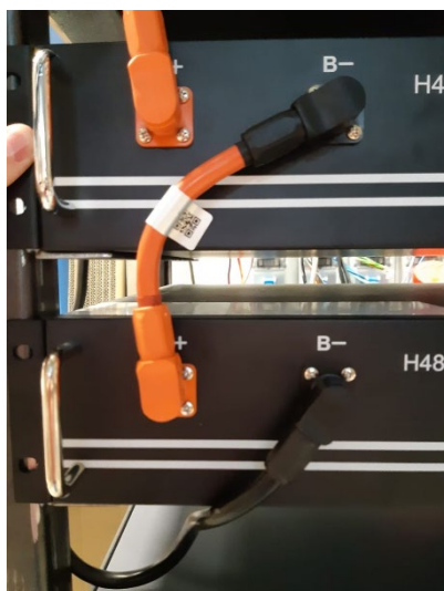
Figura 45 - Conexión de potencia (negativo) entre BMS y último módulo de batería
