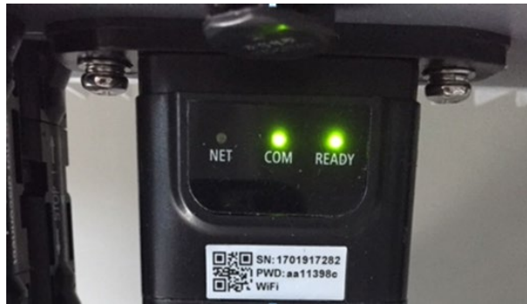
Figura 248 - Estado inicial de los led
