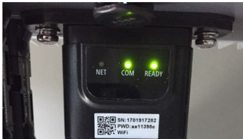
Figura 242 – Estado inicial de los led
