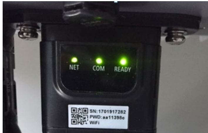
Figura 243 - Estado final de los led
