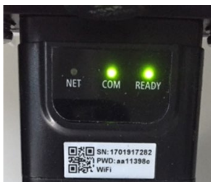
Figura 251 – Estado de comunicación irregular entre tarjeta y servidor remoto
