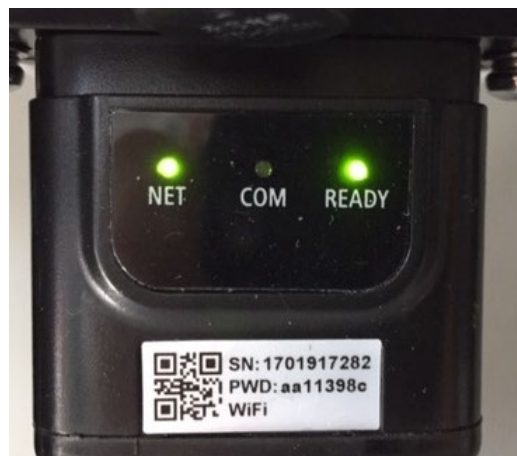
Figura 244 - Estado de comunicación irregular entre inversor y tarjeta
