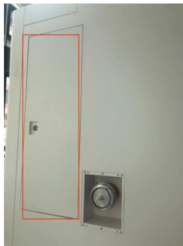
Abbildung 43 – Zugangstür zur Löschgasflasche
