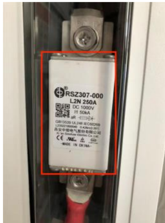
Abbildung 18 – Sicherung des Batterieclusters
